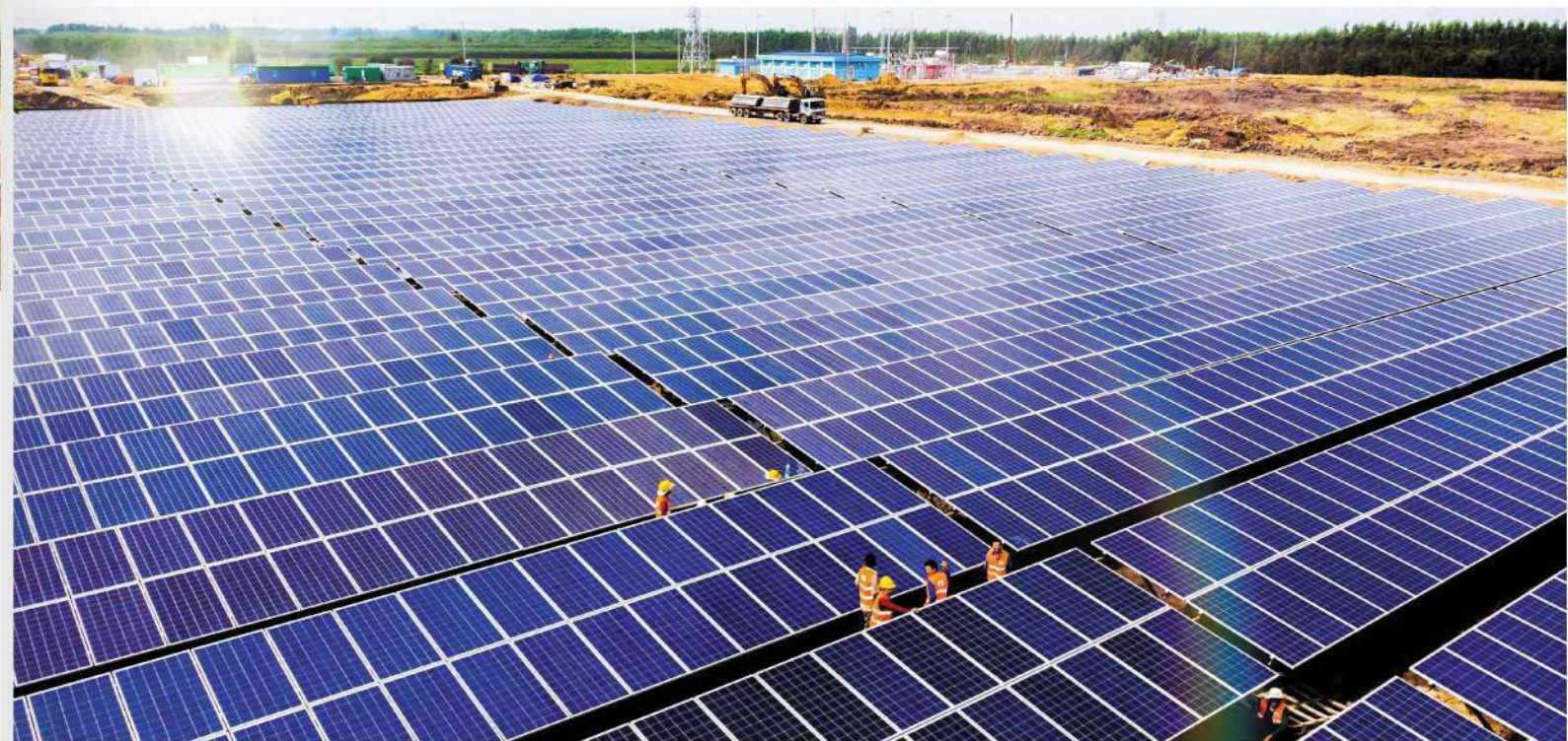
Nhà máy điện mặt trời BCG-CME Long An 2.
