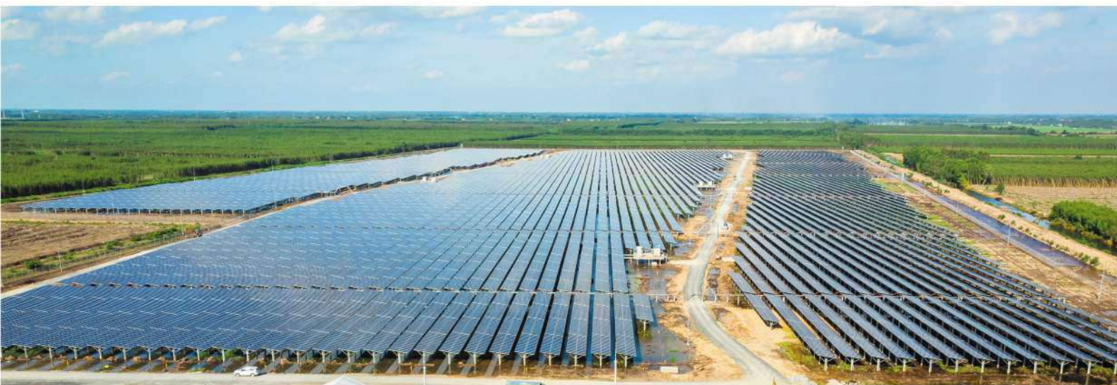
Nhà máy điện mặt trời BCG-CME Long An 1.
